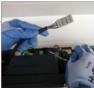
Khoang hạ áp
