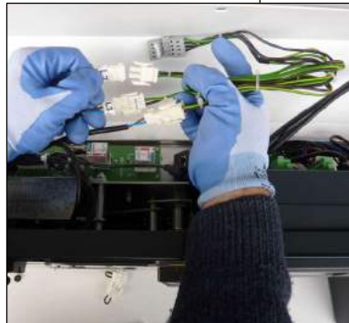
Khoang hạ áp
