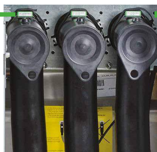
TH110 lắp đặt tại đầu nối cáp
